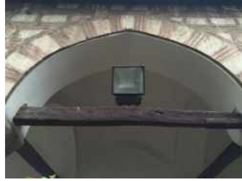
Fotoğraf 25. Ahşap Gergi Kirişlerinde Görülen Sorunlar
