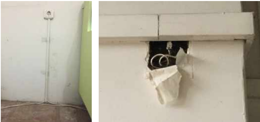
Fotoğraf 22. Açıkta Görülen Elektrik Kabloları
