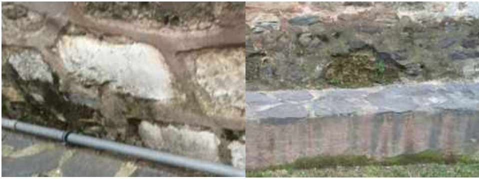
Fotoğraf 6. Duvarlarda Görülen Yosun ve Bitki Oluşumundan Örnekler
