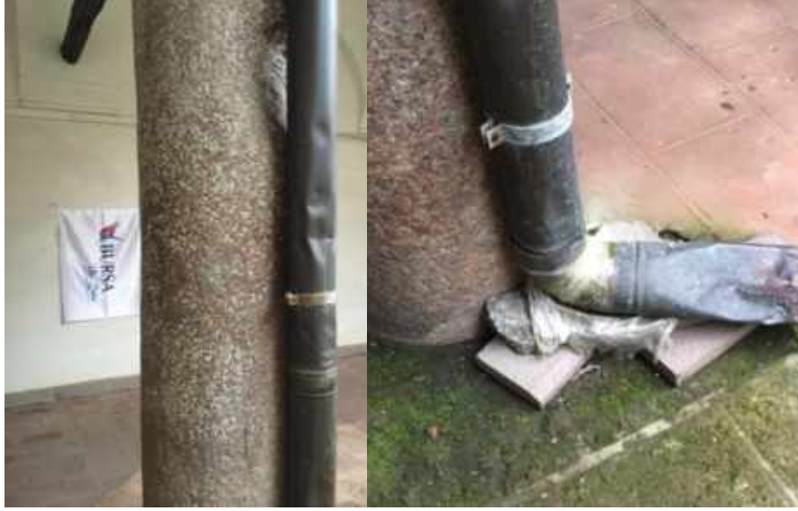
Fotoğraf 20. Su Borularında Görülen Biçimsel Deformasyonlar
