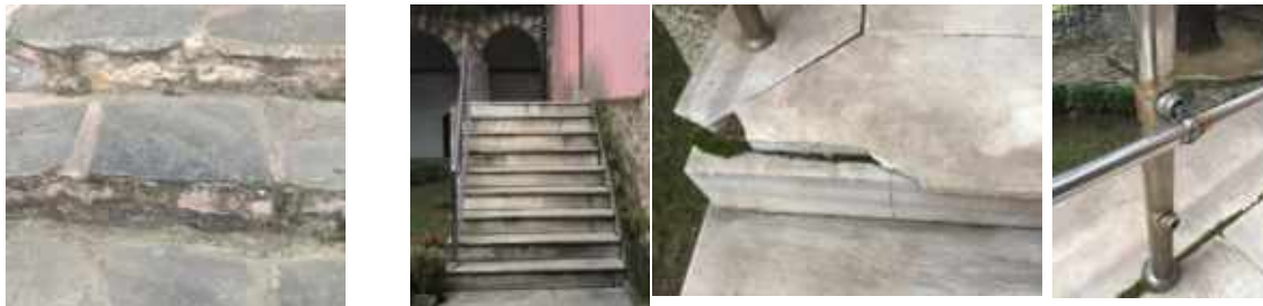
Fotoğraf 15. Merdivenlerde Görülen Çeşitli Bozulmalardan Örnekler
