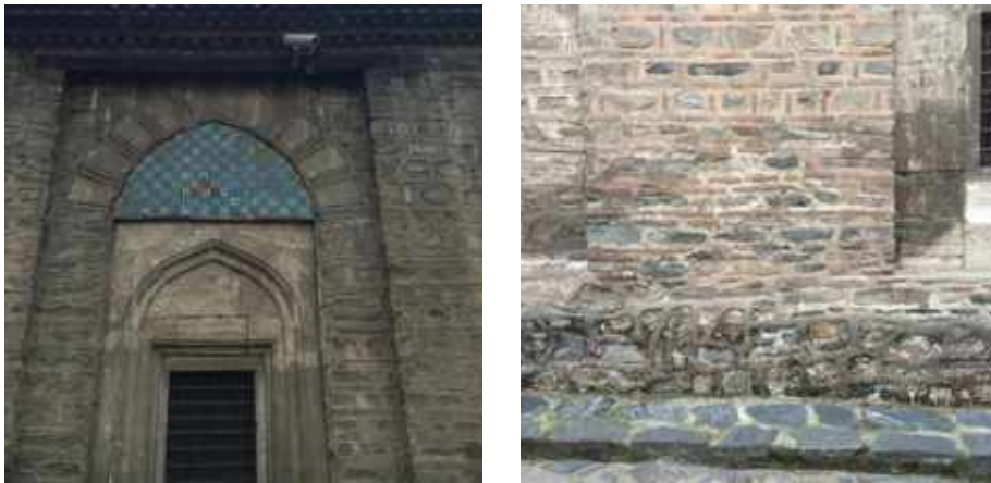
Fotoğraf 7. Duvarlarda Görülen Kirli Yüzey Oluşumundan Örnekler
