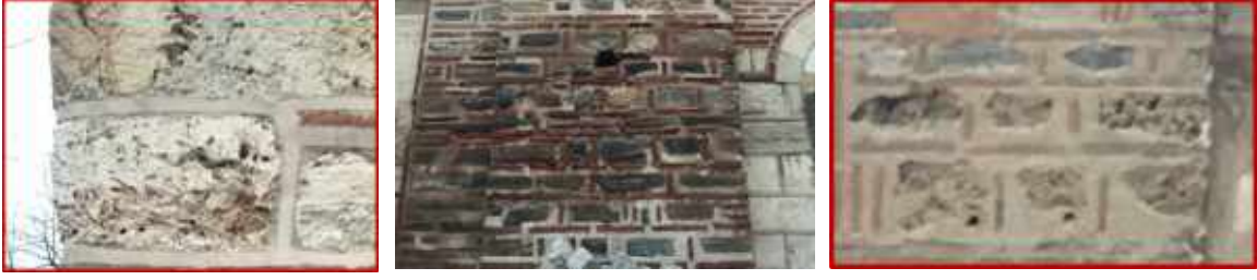
Fotoğraf 4. Duvar Malzemelerinde (Taş ve Tuğla) Görülen Yüzey Kayıplarından Örnekler
