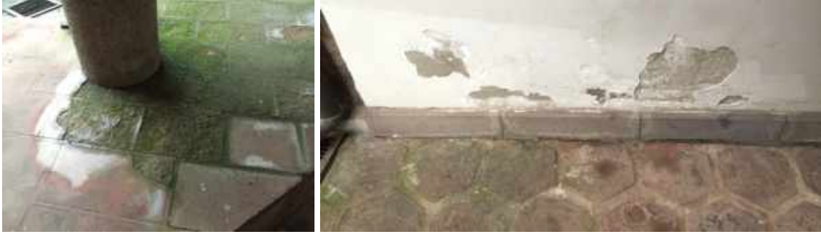
Fotoğraf 13. Döşeme Yüzeyindeki Kirlilik, Yosun Oluşumu ve Çiçeklenme
