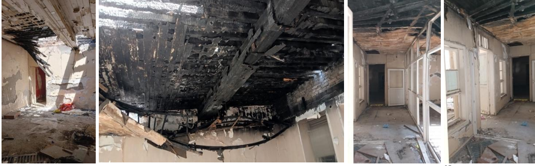
Şekil 21: 2025 yılına dair iç mekan yangın hasarı tespitleri. 68
